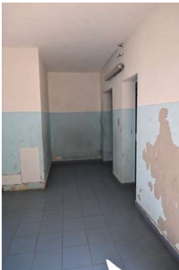
PIANEROTTOLO PIANO 11° ASCENSORI
